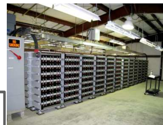
Exide/GNB 1MW (Alaska)
